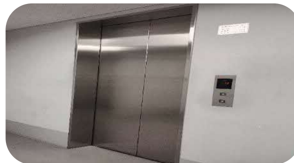
エレベーター
