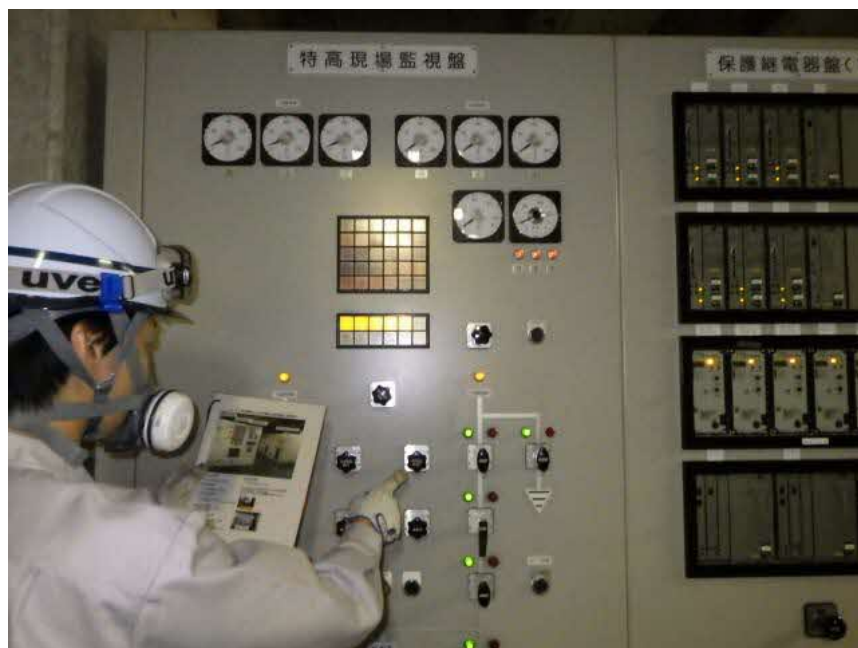
電気設備盤を点検している様子
